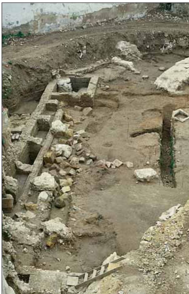
fig. 84: Vista general de l'abocador de material constructiu
