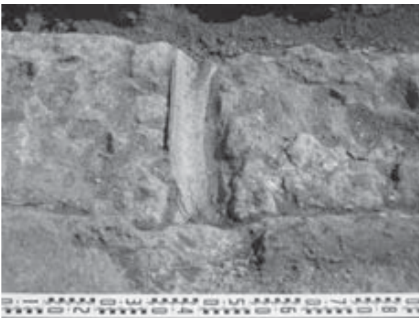
Figura 4. Detall del desguàs del segon dipòsit de decantació d'oli (Rocs).
